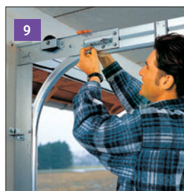
9 Podczas gdy górne prowadnice podtrzymywane są wspornikami przystępujemy do montażu łuku szyn prowadzących.
