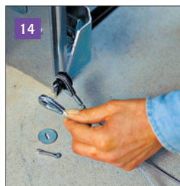
14 Linkę stalową łączącą bramę ze sprężynami mocujemy na dolnym segmencie przy mocowaniu rolek.
