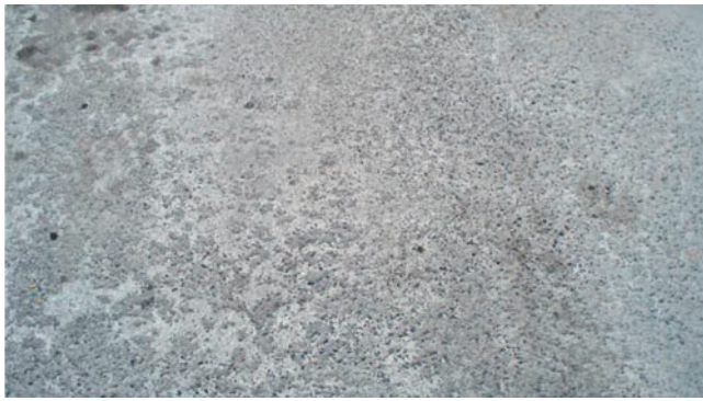
Zniszczenie betonu spowodowane brakiem pielęgnacji.
