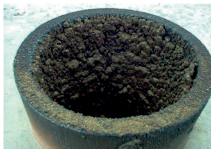
Sadza w rurze i w przewodzie kominowym
