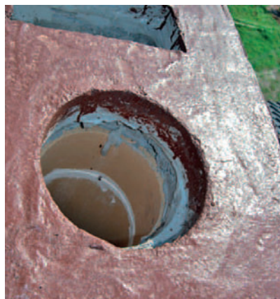
Błędne połączenie rury z czapą betonową
